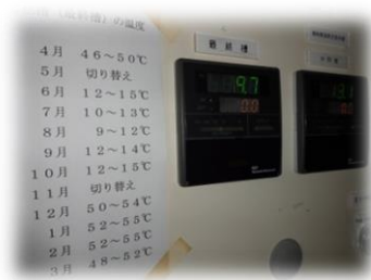
冷温水発生機適正温度チェック
